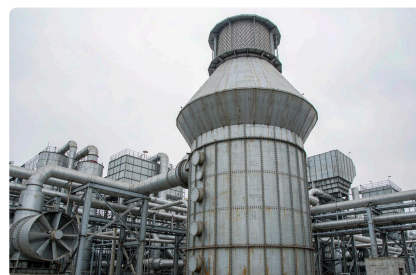
电力与烟气脱硫 Power generation & FGD 2205 · 904L + Q235B
